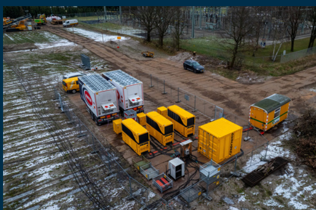
Système de production et de stockage d'électricité à base d'hydrogène, pour la fourniture d'énergie pilotable et la sécurité des réseaux.
